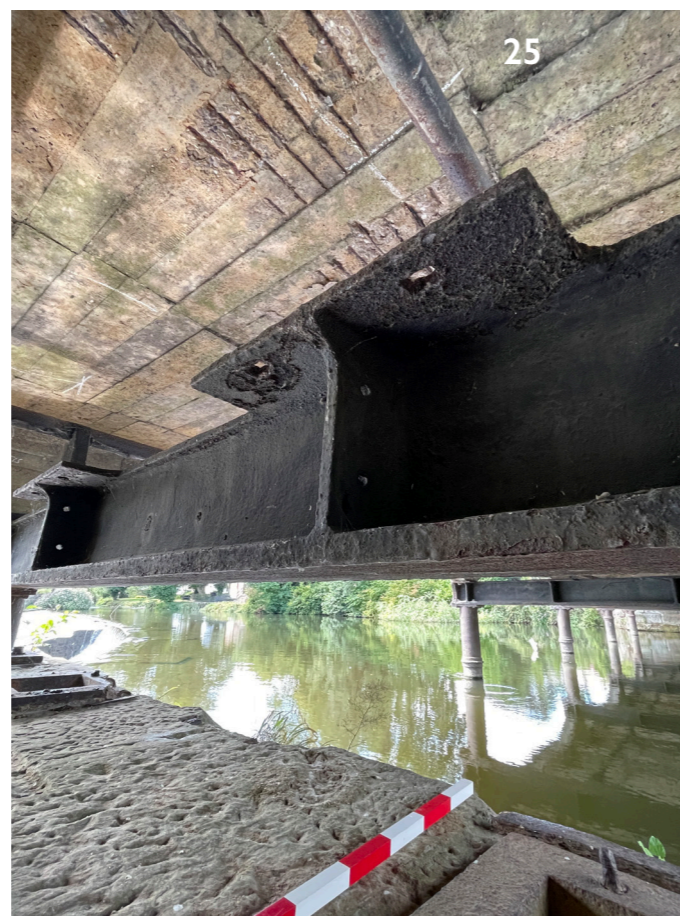
25. Central cast-iron flange (8.8.25).
